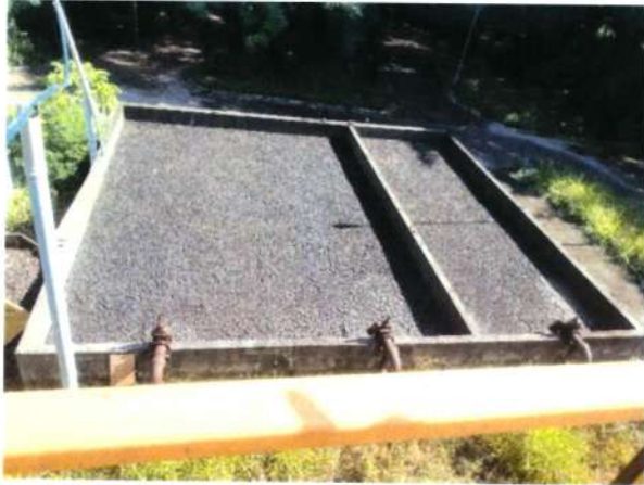
Figura 349 – Leito de secagem de lodo ETE Horto
