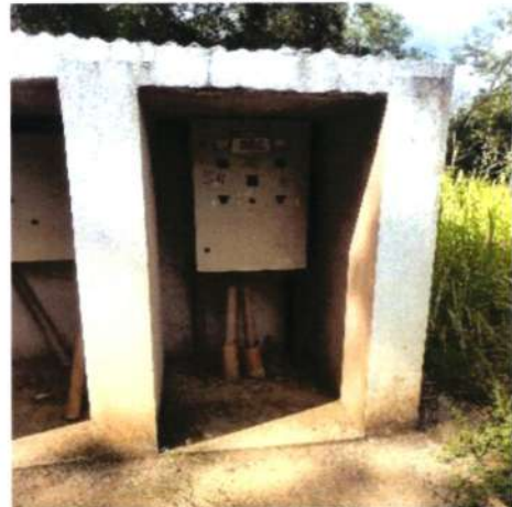
Figura 49 - Painél de Controle do Poço junto da ETA
