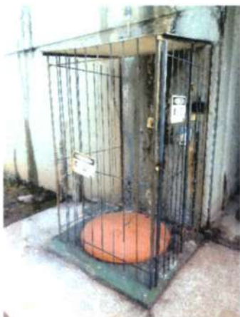
Figura 62 - Reservatório de produtos químicos
