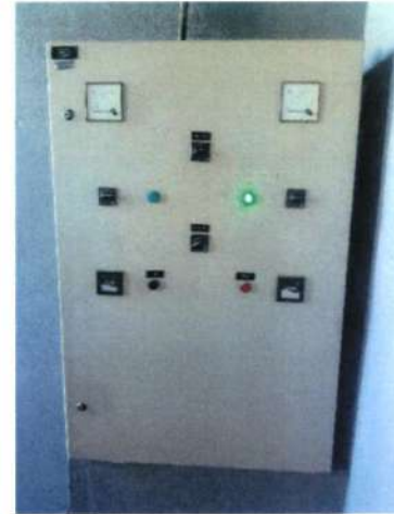
Figura 97 – Painel de comando do Booster
