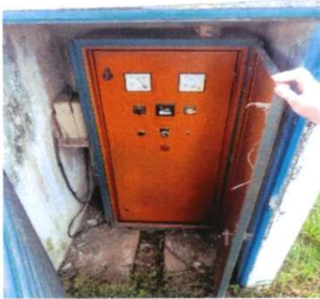
Figura 48 - Painél de Controle do Poço junto da ETA
