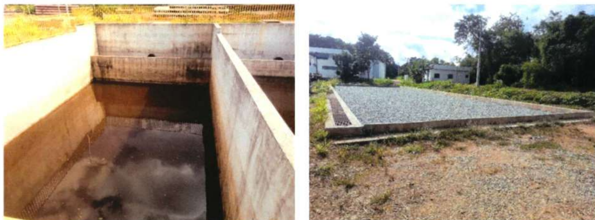
Figura 3 – Tanque de recebimento de lodo e Base para recebimento de “bags” ETA Amaro Lanari
