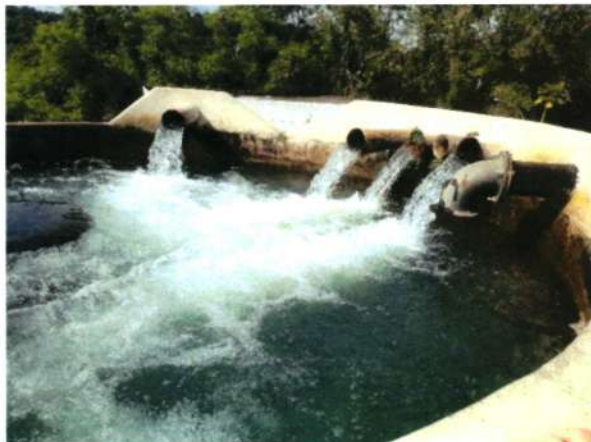
Figura 60 - Local de chegada de água bruta
