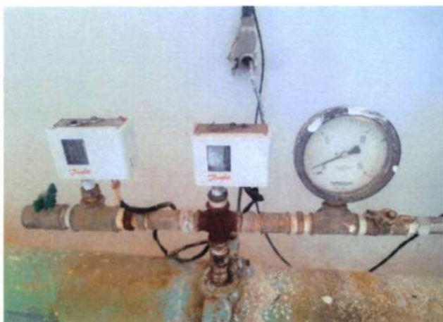
Figura 140 – Manômetro e Pressostatos do Booster
