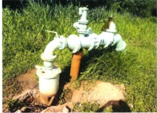
Figura 47 - Poço junto da ETA
