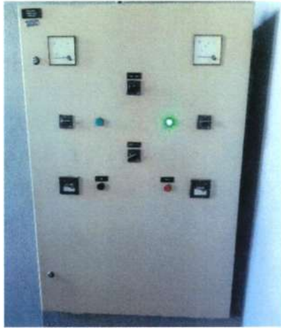
Figura 96 – Painel de comando do Booster
