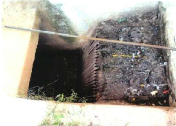
Figura 292 - Gradeamento EEE Vila Ipanema
