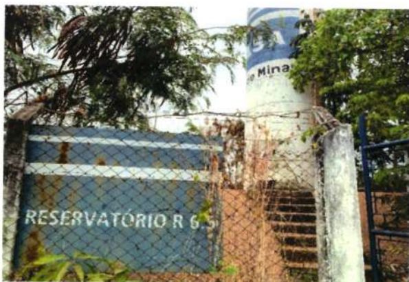
Figura 244 - Identificação do reservatório RAP-6.5
