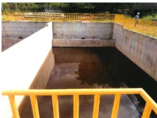
Figura 64 - Tanque para desidratação de lodo
