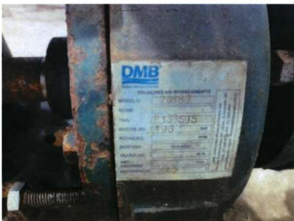
Figura 82 - Equipamentos no Booster
