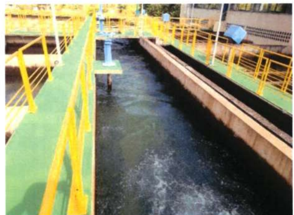
Figura 59 - Vista dos tanques de tratamento da ETA
