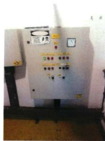
Figura 281 - Painel de comando da EEE Bairro das Águas
