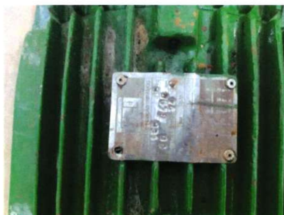
Figura 83 - Motores do Booster
