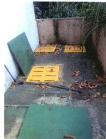
Figura 279 - Poço de sucção da EEB Bairro das Águas
