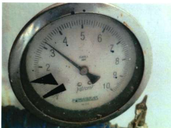
Figura 147 - Manômetro de entrada do Booster
