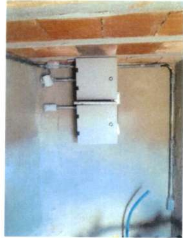
Figura 154 - Painel de elétrico EAT-2.2
