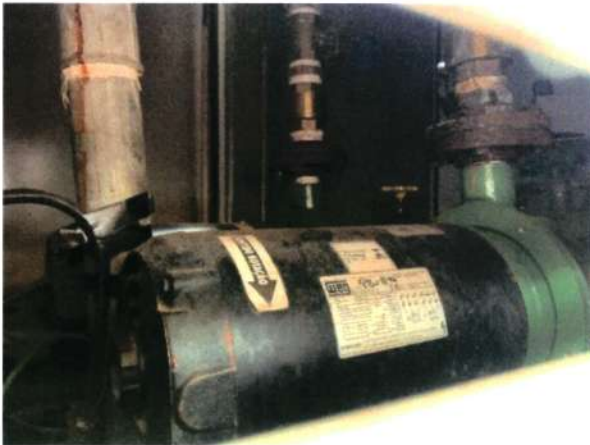
Figura 76 - Equipamentos no Booster
