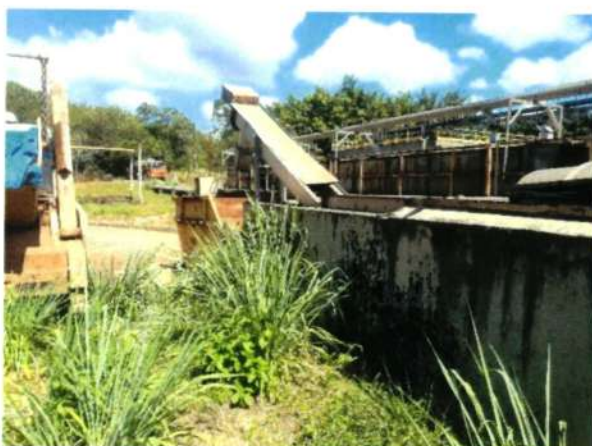
Figura 358 - Esteira elevatório do tratamento preliminar de esgoto ETE Ipanema
