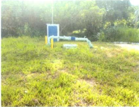
Figura 46 - Poço junto da ETA
