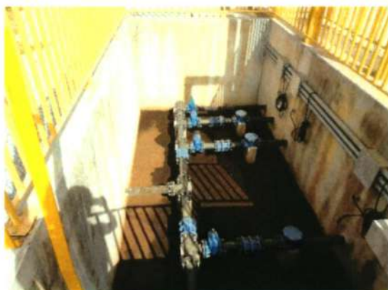
Figura 66 - Tanque para desidratação de lodo
