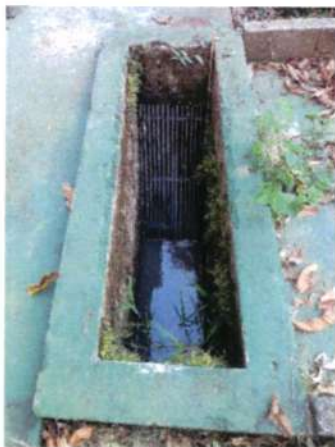
Figura 278 – Gradeamento EEB Bairro das Águas
