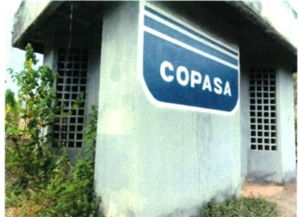
Figura 117 - Estrutura do Booster Morro Cruzeiro
