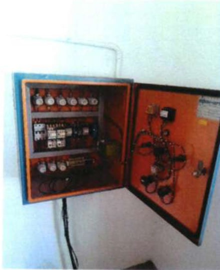
Figura 149 – Painel de comando do Booster
