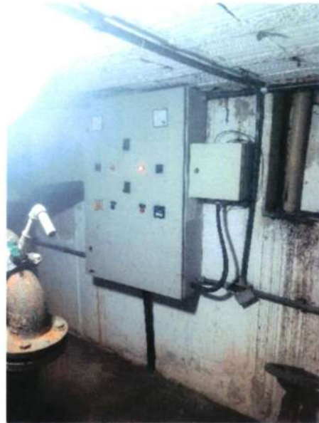
Figura 108 - Painel de comando do Booster
