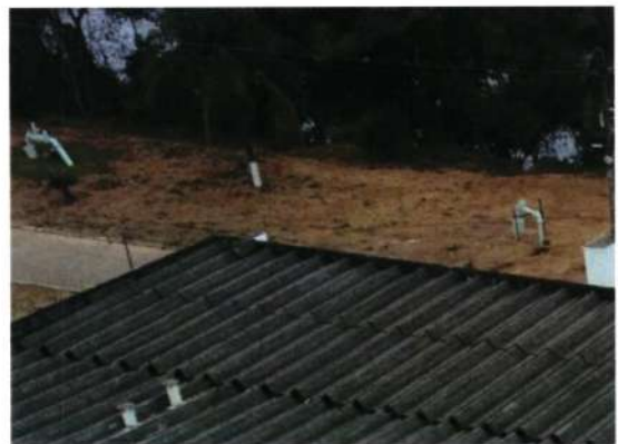
Figura 45 - Poços junto da ETA
