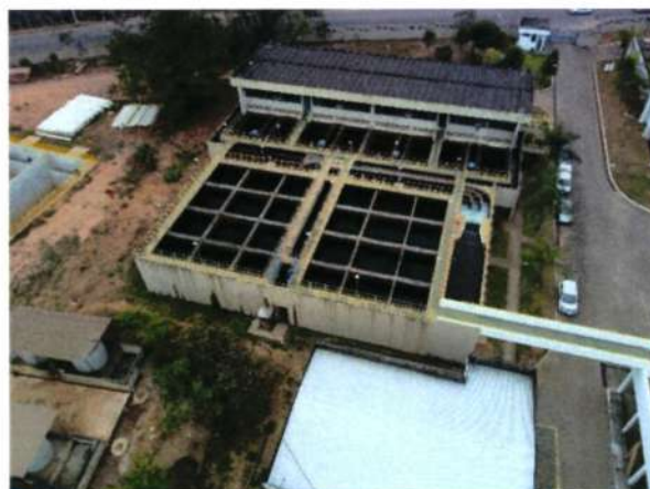
Figura 53 - Vista dos tanques de tratamento da ETA
