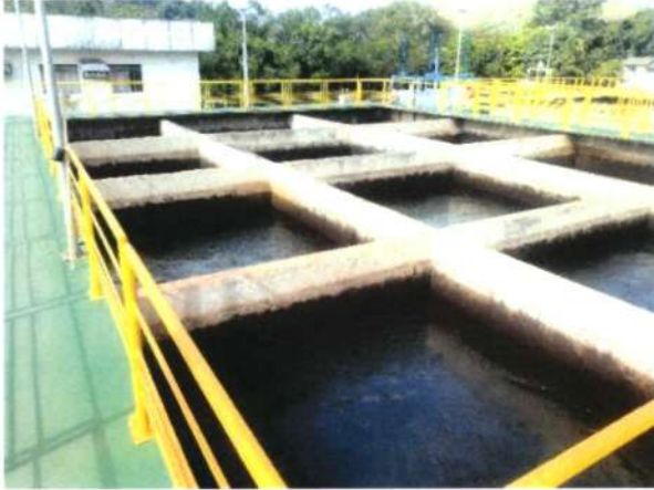
Figura 56 - Vista dos tanques de tratamento da ETA
