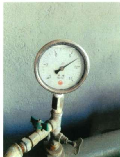
Figura 101 – Manômetro de saída do Booster
