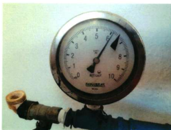
Figura 148 - Manômetro de saída do Booster
