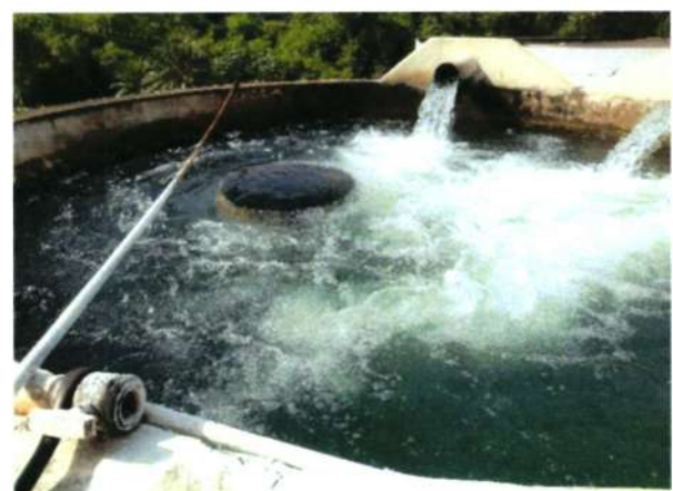
Figura 61 - Local de chegada de água bruta
