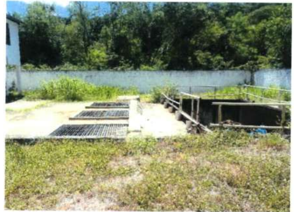
Figura 293 – Poço de sucção EEE Vila Ipanema
