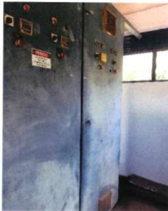
Figura 294 - Painel de comando EEE Vila Ipanema
