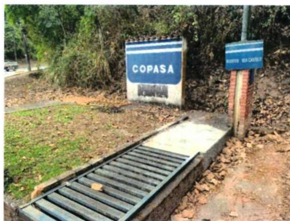
Figura 102 – Estrutura e identificação do Booster
