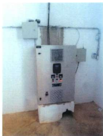
Figura 138 – Painel de comando do Booster
