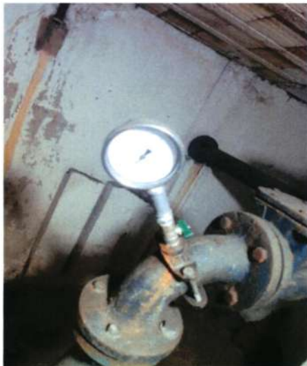
Figura 109 – Manômetro de entrada do Booster
