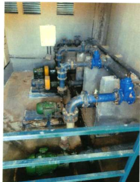
Figura 180 - Estrutura Hidromecânica da EAT-6.1 e EAT-6.2
