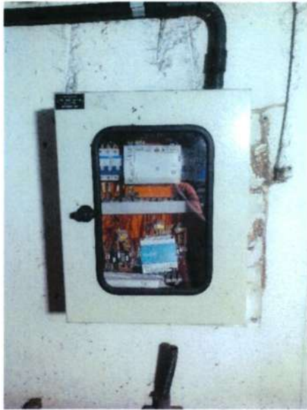
Figura 107 - Painel de comando do Booster
