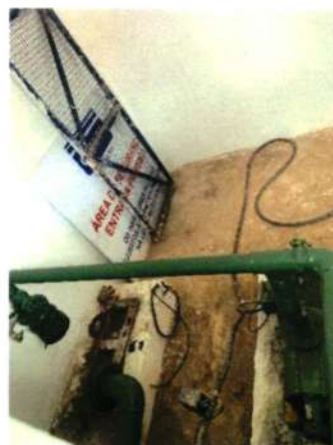
Figura 113 - Equipamentos dentro do Booster
