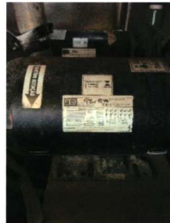
Figura 77 - Motores do Booster
