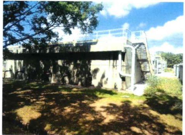
Figura 367 – Filtros Biológicos ETE Ipanema
