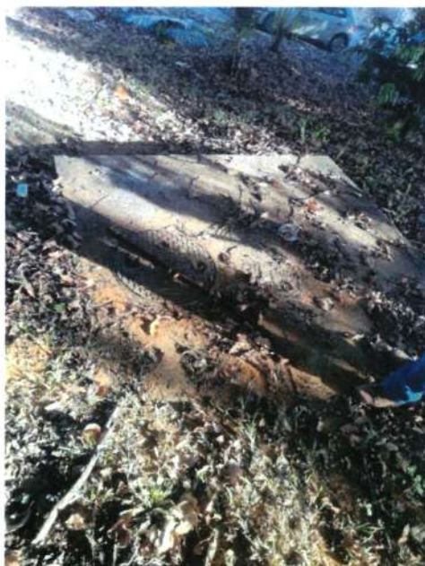
Figura 73 - Acesso ao Booster
