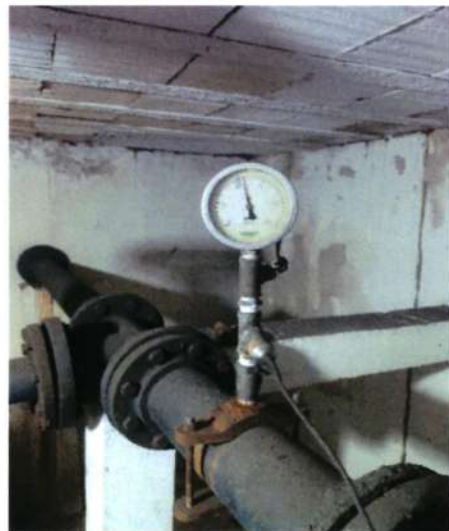
Figura 110 - Manômetro de saída do Booster
