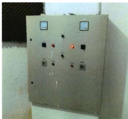
Figura 85 – Painel de comando do Booster
