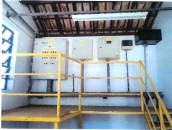
Figura 308 – Painel de comando EEE Novo Centro
