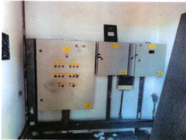
Figura 287 – Painel de comando EEE Castelo
