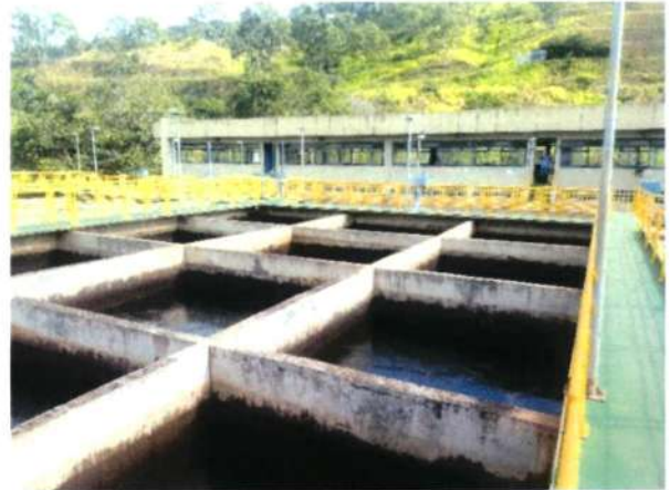
Figura 57 - Vista dos tanques de tratamento da ETA
