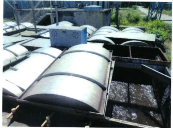
Figura 361 – Desarenador ETE Ipanema
