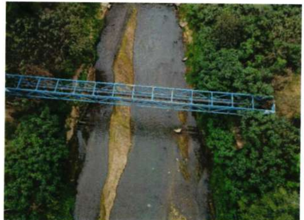
Figura 353 - Linha de recalque ETE Ipanema
