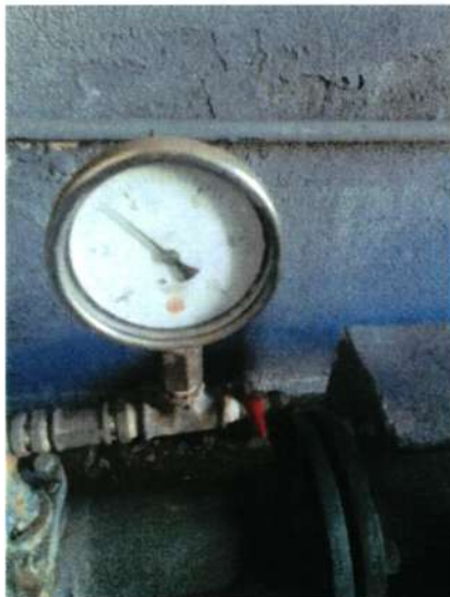
Figura 100 – Manômetro de entrada do Booster
