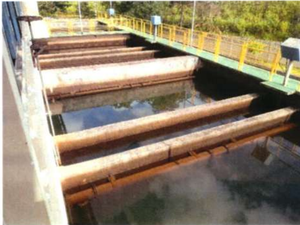
Figura 58 - Vista dos tanques de tratamento da ETA
