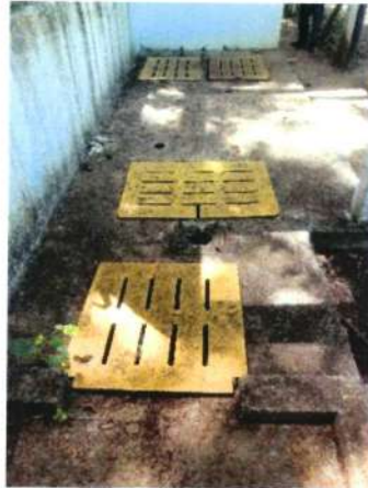
Figura 289 – Poço de sucção EEE Castelo
