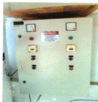
Figura 312 – Painel de comando EEE Vila da Paz
