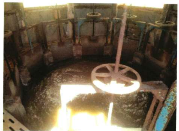
Figura 359 - Entrada de esgoto bruto ETE Ipanema
