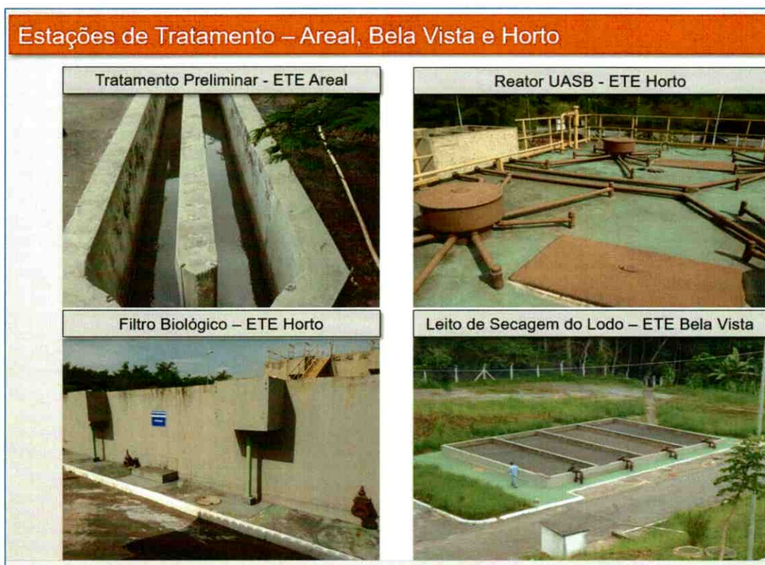
Figura 2.5– Estações de Tratamento de Esgoto: ETE's Areal, Bela Vista e Horto
