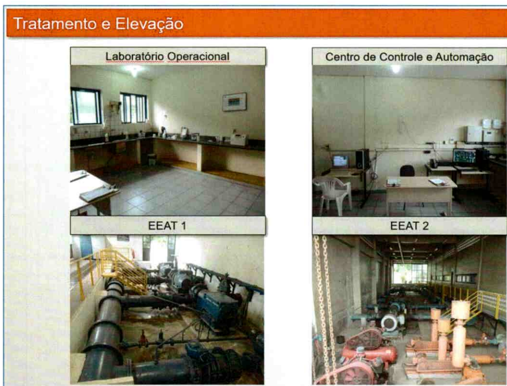
Figura 2.2 - Estação de Tratamento de Água: ETA Amaro Lanari
