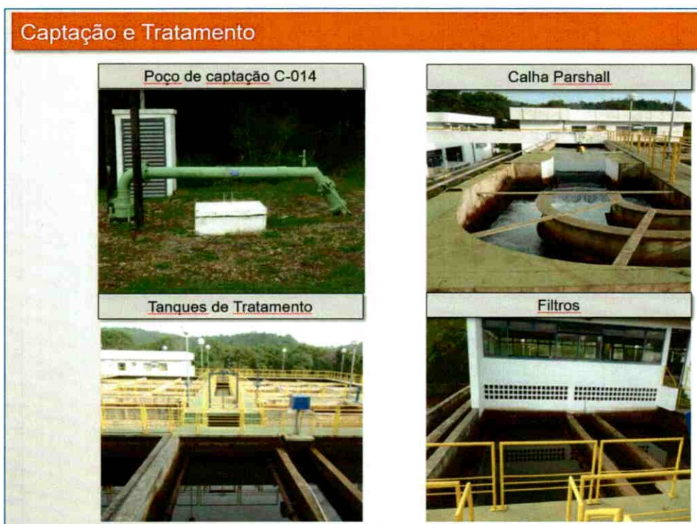
Figura 2.1 – Estação de Tratamento de Água: ETA Amaro Lanari
